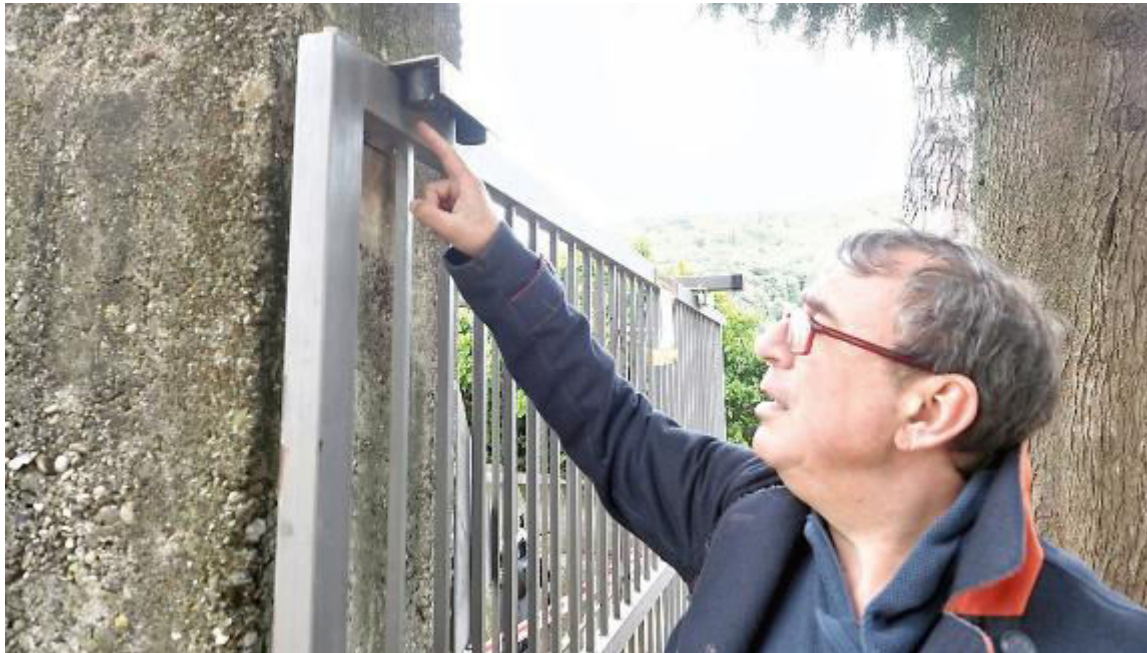
Le guide superiori del cancello scorrevole del parco di Pugliola che non hanno scongiurato il ribaltamento
